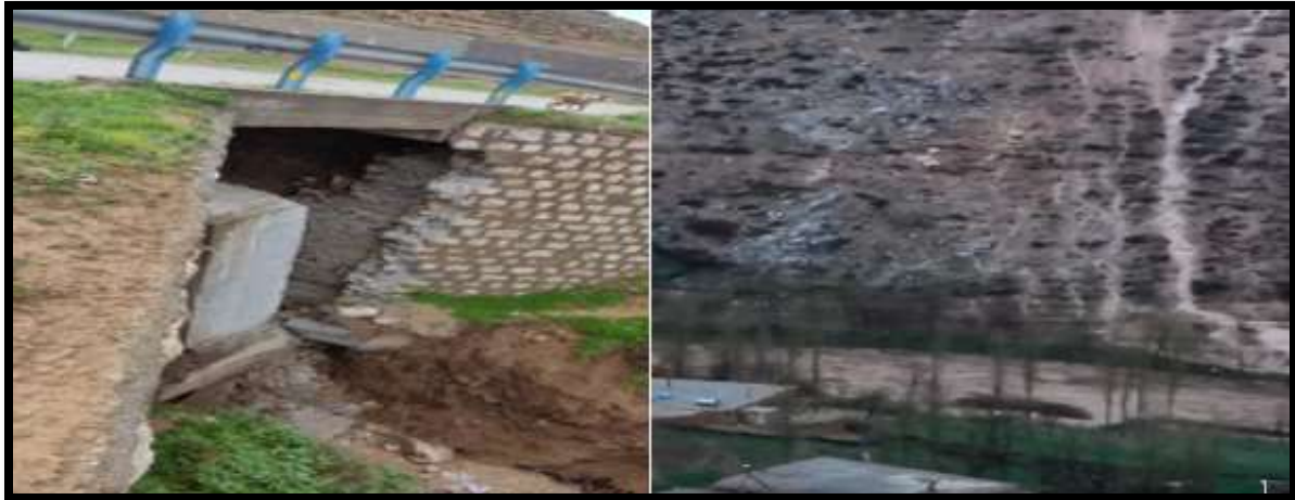
شکل شماره ۱۸: طغیان رودخانه در روستای نراب و تخریب پل خروجی روستای کاشیدار به سمت نراب در تاریخ ۱۴۰۳/۰۱/۰۷
