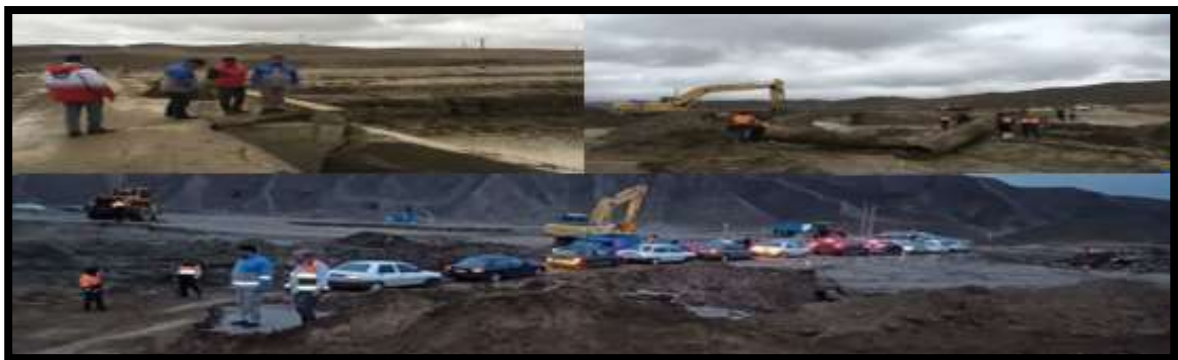
شکل شماره ۱۱: آب گرفتگی و ایجاد خسارت به بخش هایی از پل موقت در روستای اوقچی از توابع شهرستان کلالة در تاریخ ۱۴۰۲/۰۷/۲۰
