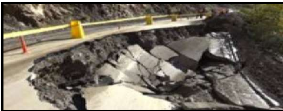
شکل شماره ۱۴: تخریب بخشی از جاده النگ استان گلستان به دلیل وقوع سیلاب در تاریخ ۱۴۰۲/۰۸/۱۶
